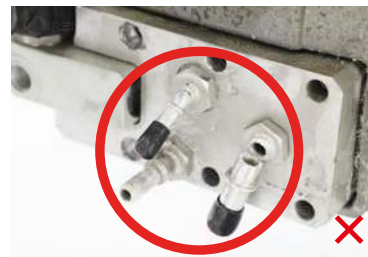
Vaurioituneet / puuttuvat polttoainesuuttimet
